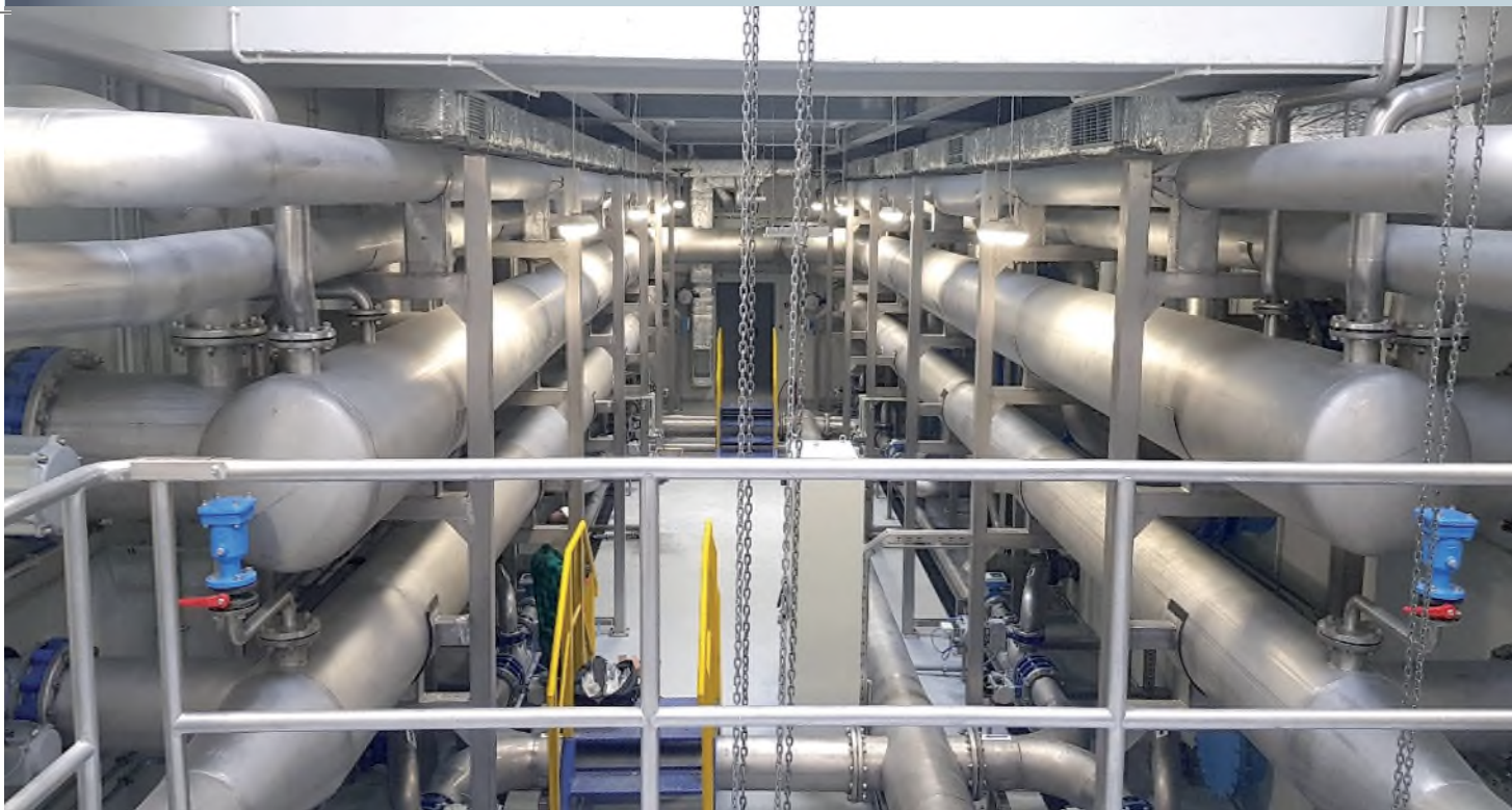
Rysunek 2b. Hala filtrów II stopnia – galeria rurociągów technologicznych komór filtracyjnych II stopnia.
