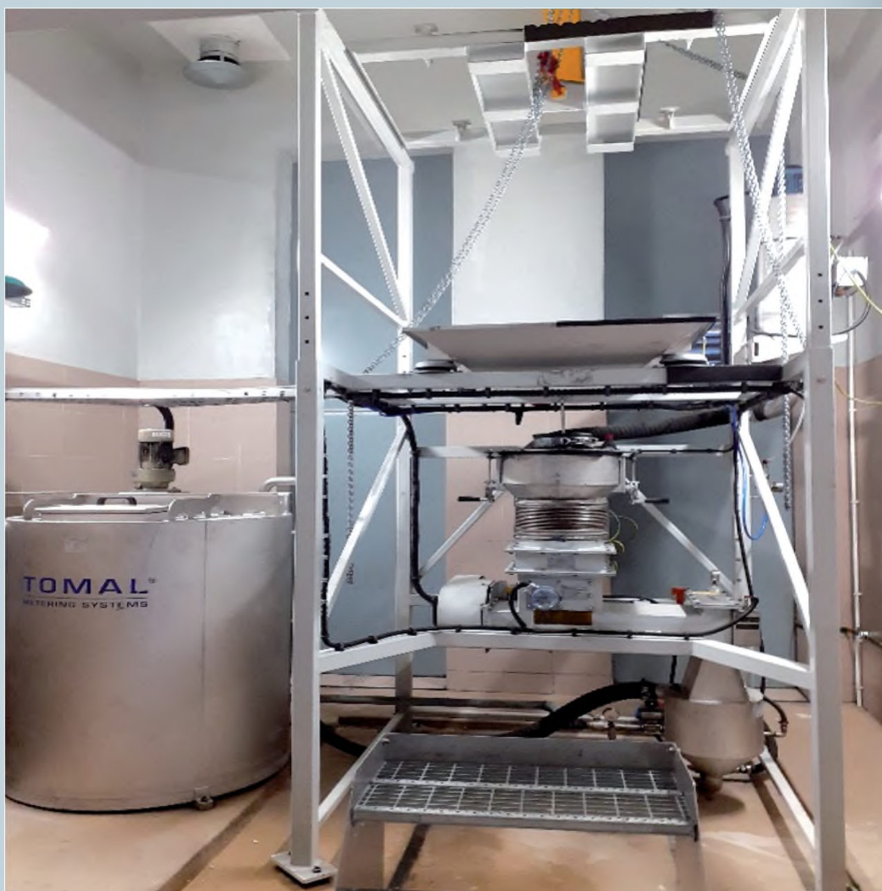
Rysunek 1. Stacja dozowania pylistego węgla aktywnego.
