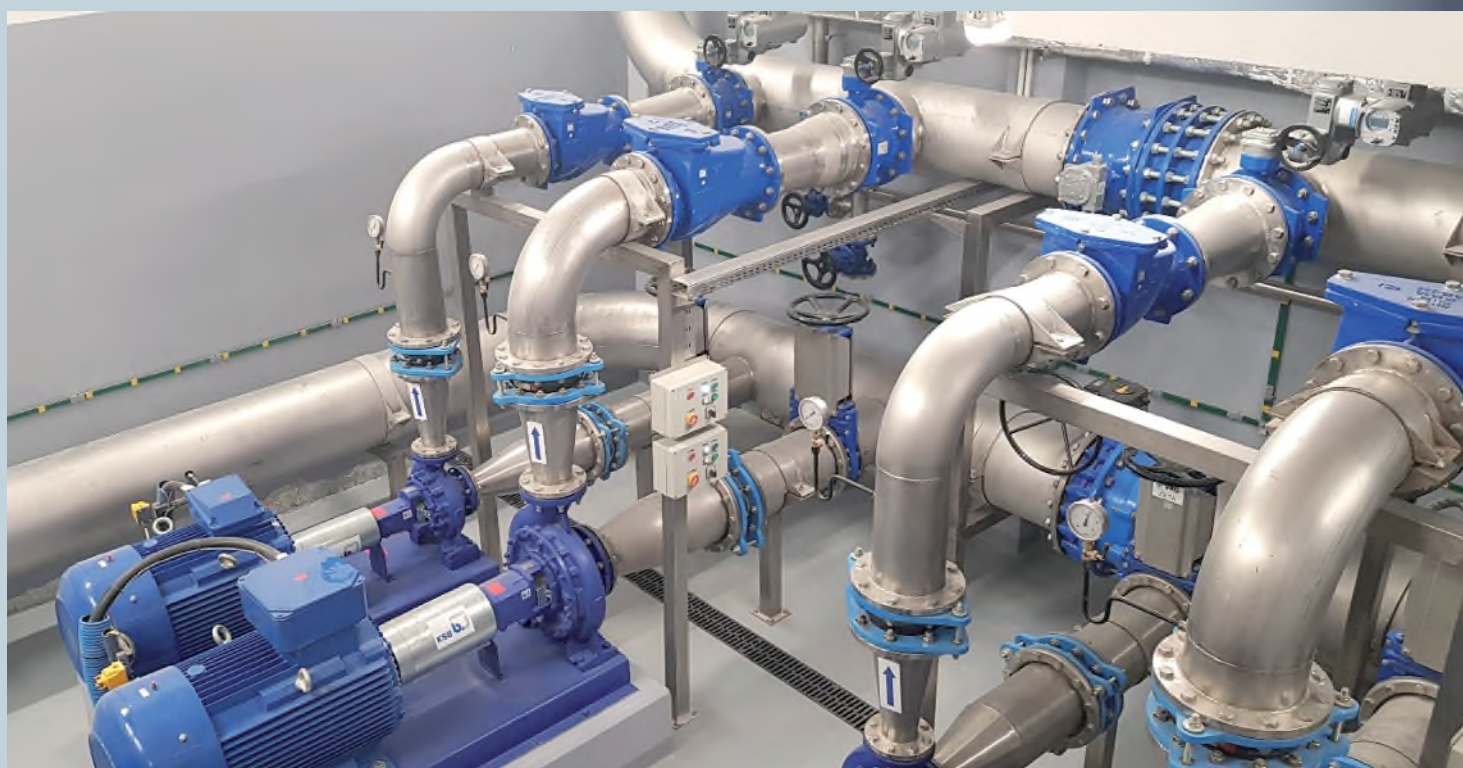
Rysunek 5. Pompownia wody do miasta.
